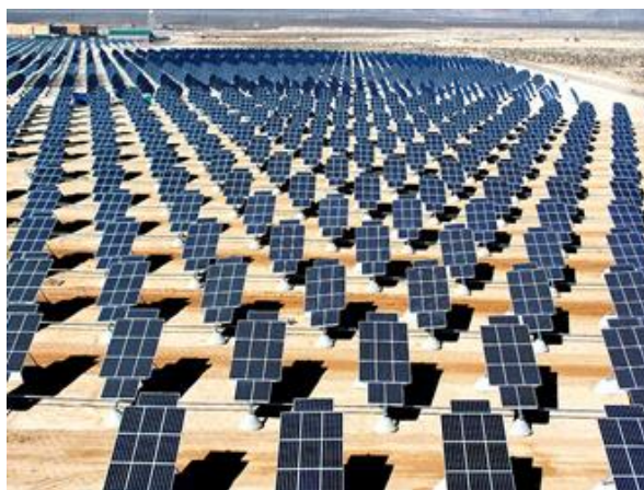
2.9. ábra. A nevadai Nellis Légierő Támaszpontra telepített fotovoltaikus napenergia hasznosító rendszer. A 140 hektárt elfoglaló 70.000 napelem közel 15 MW energia termelésére képes. (Forrás: USAF Photographic Archives)
